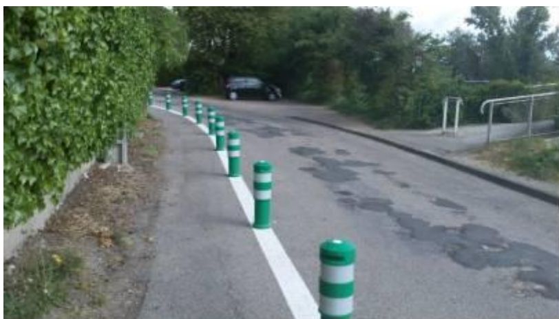
Réalisation mai/2011 rue V. Hugo : rue sans trottoir et virage sans visibilité : itinéraire vers gare et écoles
